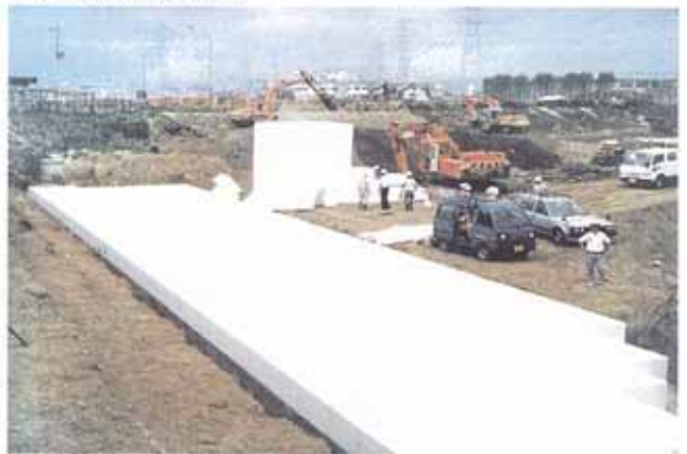
4.EPS設置部全景
