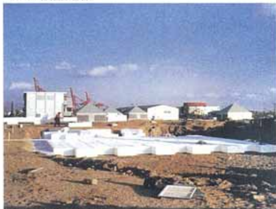
3.EPS設置部全景
