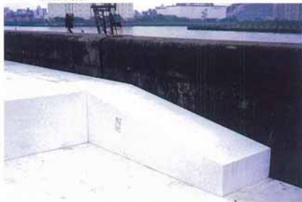
4. EPS最上段・斜めカット部
